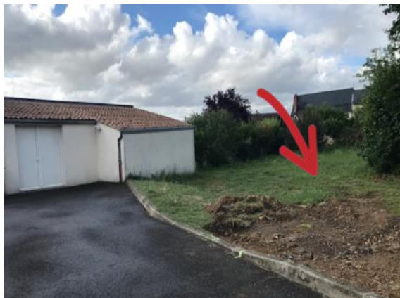
Préparation de l'emplacement de la dalle pour déplacement des containers près de la salle des fêtes
